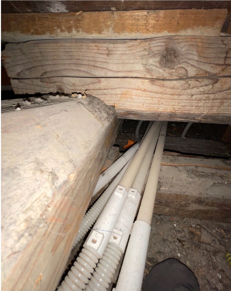
Kuva 18. Parven lattian alapuolisia sähkövetoja.
